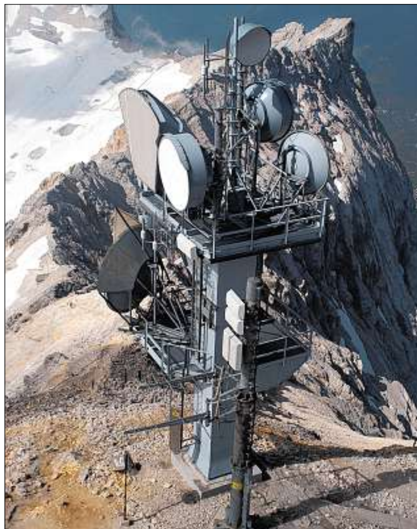
Antennas per la transmissiun radiofonica.
