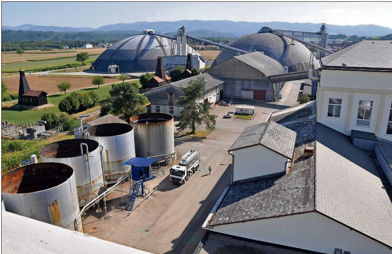
Snuizi sin il tetg da la salina da Riburg – malgrà la bella vista – pertge il bajetg ballucca in zichel pervi dal turnigl da la sola en la tarmenta chaldera.
