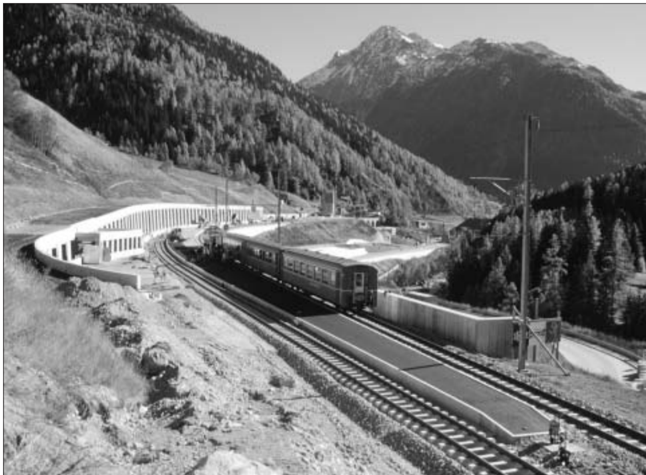
Staziun da chargiar ils autos a Sgaliains en Engiadina durant la construcziun.
